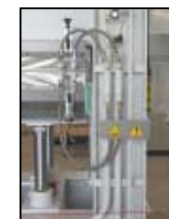
Impianto di riscaldamento Heating system Heizkreisanschlüsse
